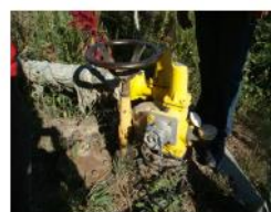
Compteur d'eau (voisin)
